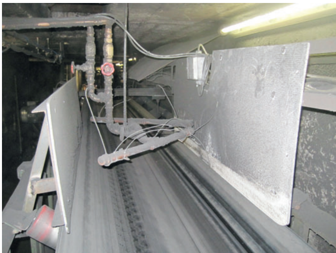
Bild 7: V-Düse für die Vorbefeuchtung mit Seitenabdeckung des Transportbandes
